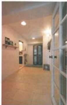
扉裏を削って広げた玄関ホール。靴箱は裏を外して壁をDIY。ドアは塗装して再利用
